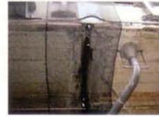
劣化進行状況が目視可能
